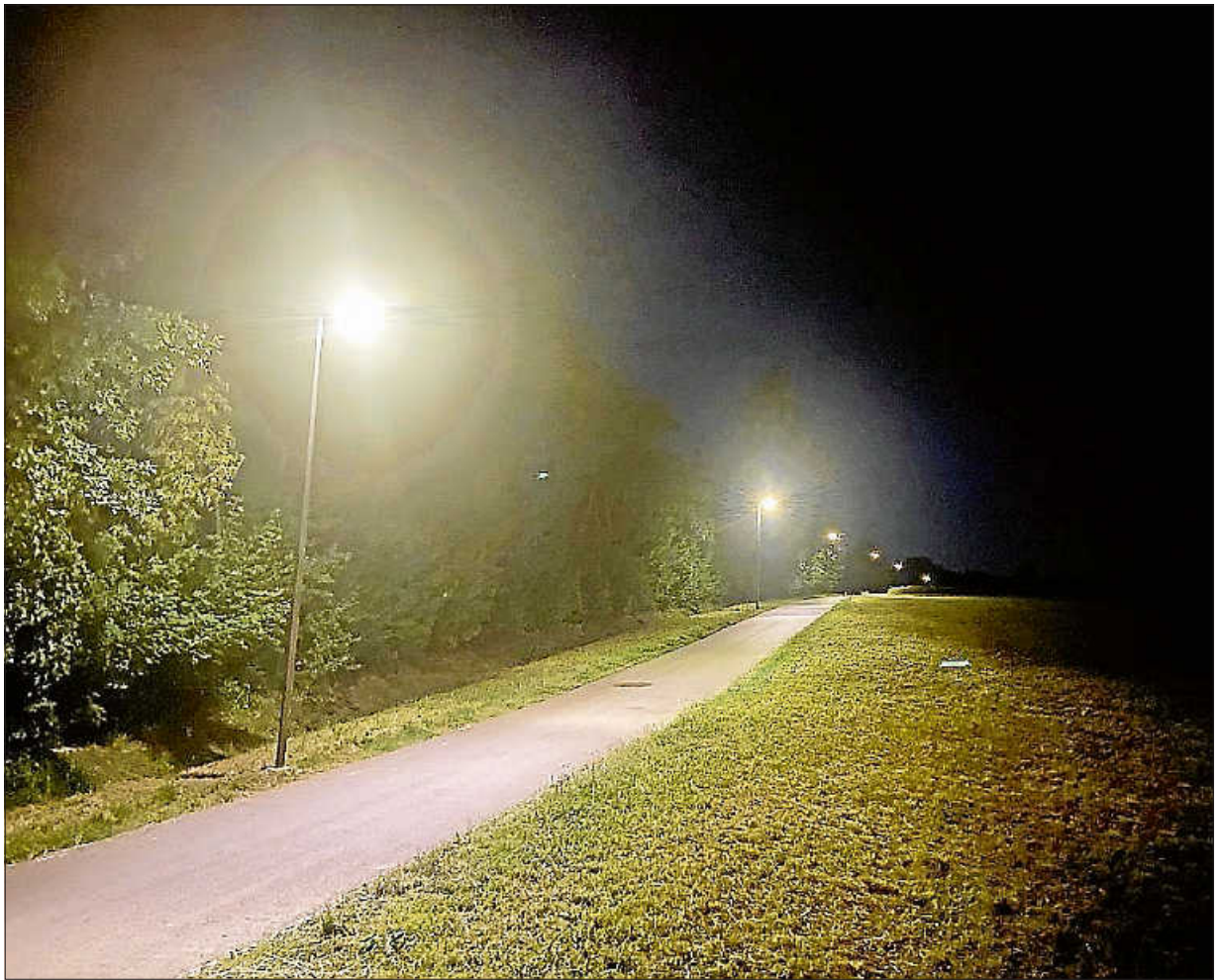
Neue innovative Solarleuchten am Radweg Perouse - Rutesheim.
